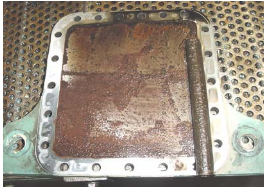
Foto 3 Tampa base de um compressor semi – hermético, ocasião onde “não se trocava” o óleo periodicamente. Havia muitas limalhas provenientes da instalação misturas de óleos não recomendados pela Bitzer. O filtro de arraste de óleo estava completamente entupido.
