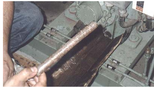
Foto 2 Filtro de arraste do óleo entupido de “limalhas de cobre” provenientes da instalação. Recomenda-se sua limpeza sempre que houver baixo diferencial de pressão da bomba de óleo ou nas trocas periódicas do óleo do cárter
